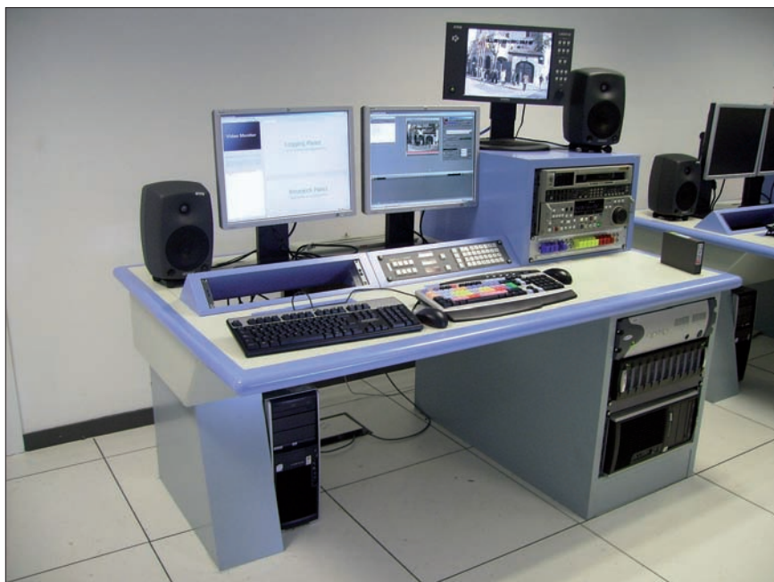
Puesto de trabajo de ingesta local
